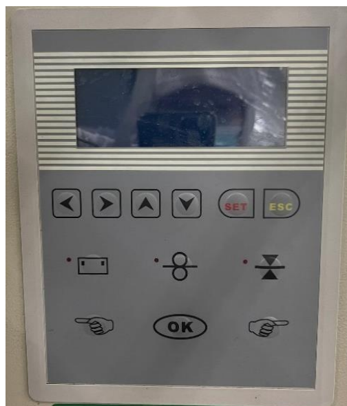
ภาพที่ 4.10 หน้าจอควบคุมเครื่องห่อแวนอนหลังปรับปรุง
