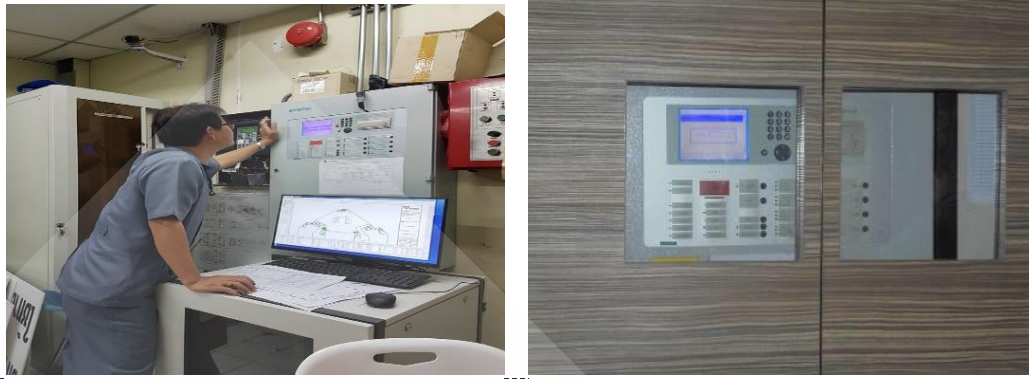
ภาพที่ 3.33 ตู้ควบคุมระบบแจ้งเหตุเพลิงไหม้ ชนิดระบุตำแหน่งเป็นกลุ่มพื้นที่
