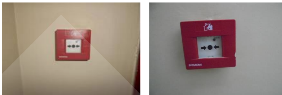
ภาพที่ 3.35 อุปกรณ์แจ้งเหตุเพลิงไหม้ ชนิดแจ้งเหตุที่ใช้มือ
