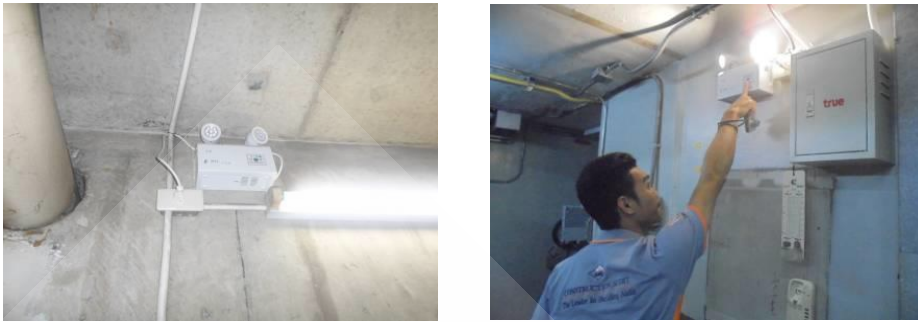
ภาพที่ 3.42 ระบบไฟแสงสว่างฉุกเฉิน
