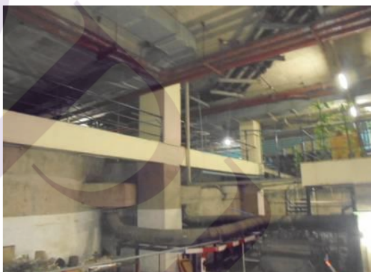
ภาพที่ 3.32 ระบบบำบัดน้ำเสียภายในอาคารเอสวี ซิตี้ อยู่ที่ชั้นใต้ดินของตัวอาคาร
