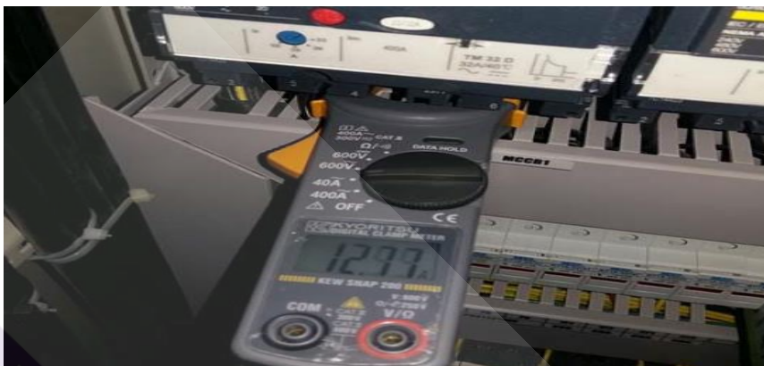
ภาพที่ 4.9 การตรวจเช็คระบบไฟฟ้าขณะอุปกรณ์ทำงาน
