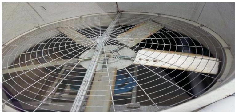
ภาพที่ 4.1 การตรวจเช็คระบบใบพัดดูการคลายตัวของกรงล้อ
