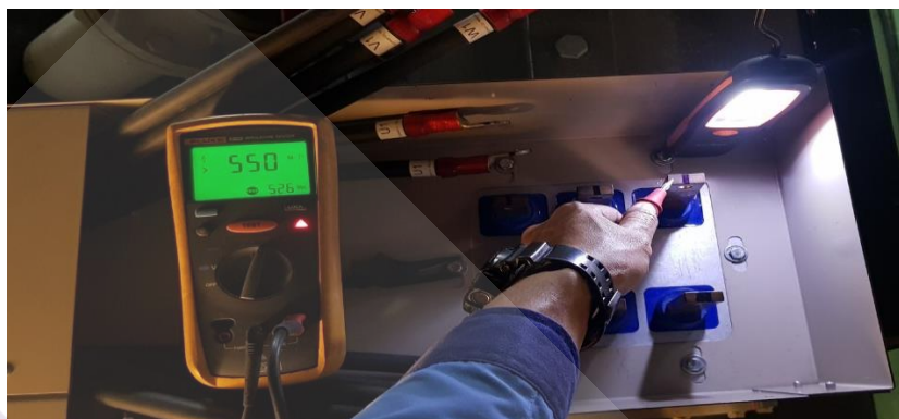
ภาพที่ 4.17 การตรวจเช็คค่าความเป็นฉนวนของมอเตอร์คอมเพรสเซอร์
