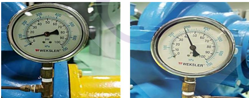
ภาพที่ 4.10 การตรวจเช็คค่าแรงดันของปั้มน้ำด้านเข้าและออก
