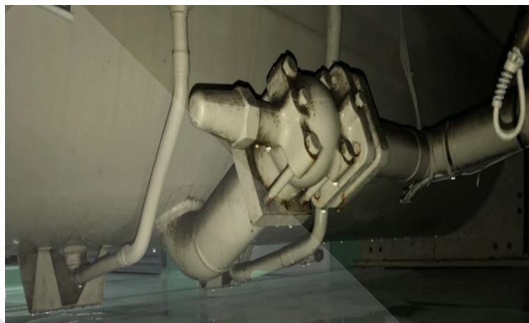
ภาพที่ 3.20 สภาพการเกิดคอนเดนที่บริเวณชุดคอนเดนเซอร์
