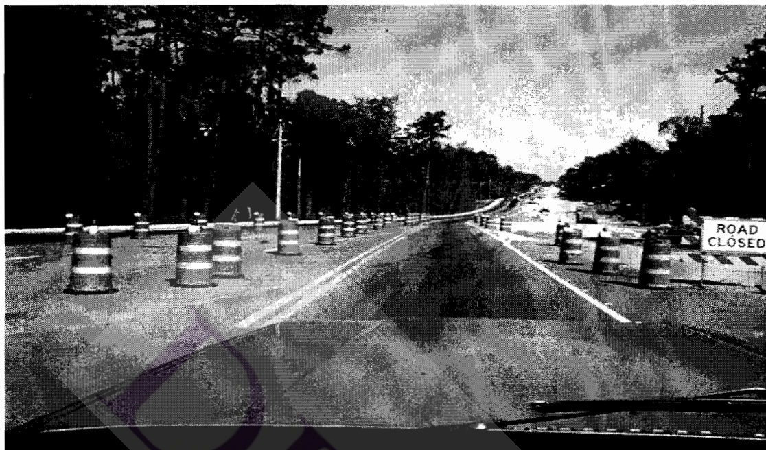
ภาพที่ 2.9 แสดงถึงรูปภาพของการซ่อมถนน และมีสิ่งกีดขวางต่างๆอยู่บนท้องถนน
