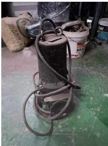
ภาพที่ 4.36 แสดงเครื่องปั้มน้ำที่ใช้ในอาคารแห่งนี้
