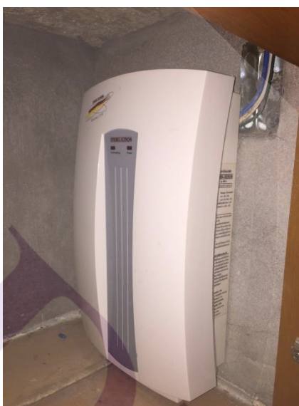
ภาพที่ 4.33 เครื่องทำน้ำอุ่นภายในโรงแรม
