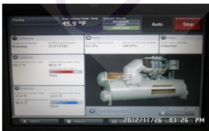
รูปที่ 3.13 ระบบควบคุมเครื่องทำความเย็น (Chiller Operation) SUMMIT TRANE
