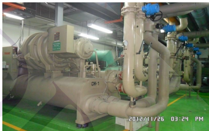
รูปที่ 3.5 เครื่อง Chiller ที่อาคารโรงพยาบาลพระรามเก้า
