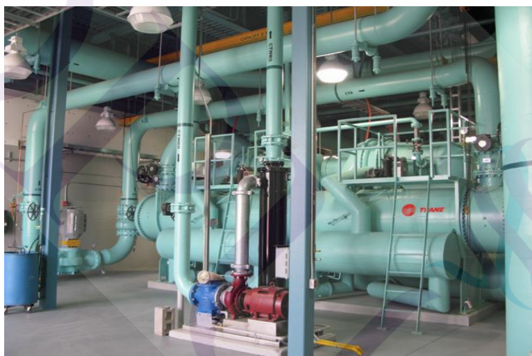
รูปที่ 2.7 เครื่องทำน้ำเย็น
