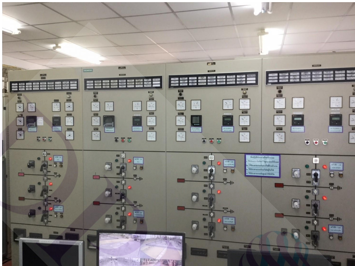
ภาพที่ 2.3 ตู้วงจรไฟฟ้าระบบ 115 kV ซึ่งในแต่ละวงจรจะมีการติดตั้งคิวิตัลเพาเวอร์มิเตอร์ไว้
