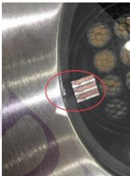
ภาพที่ 3.2 กระจกโคมไฟร้าวหรือ End cap ร้าว
