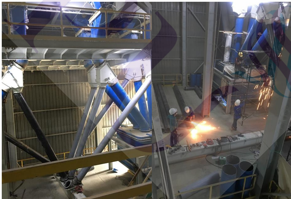
ภาพที่ 3.8 แสดงระหว่างการปรับปรุงติดตั้งระบบลำเลียงอาหารจากถังบรรจุอาหารเบ้าท์ ไปยังถังบรรจุอาหารกระสอบ
