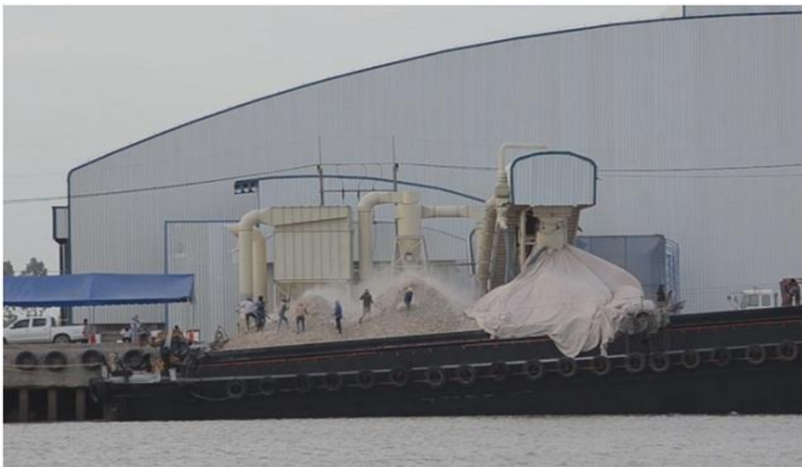
ภาพที่ 3.4 การขนส่งแป้งมันสำปะหลังบริเวณโครงการก่อสร้างท่าเทียบเรือบ้านโพธิ์ จังหวัดฉะเชิงเทรา 118
