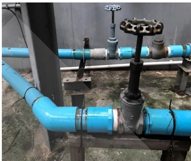
ภาพที่ 4.2 ตรวจสอบเช็คอุปกรณ์ชุดวาล์วควบคุมแรงดัน
