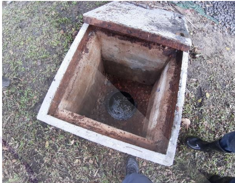
ภาพที่ 4.7 เปิดบ่อดักไขมันเพื่อดูและทำความสะอาด
