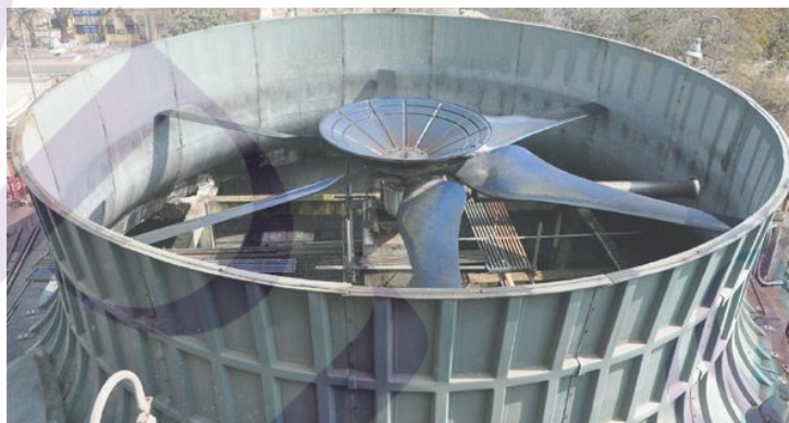
ภาพที่ 2.12 พัดลมที่ใช้ในหอหล่อเย็น
