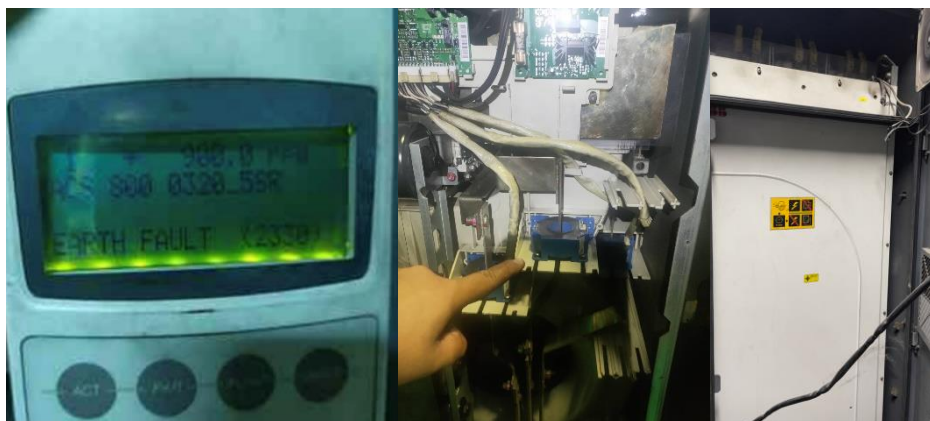
ภาพที่ 4.4 ปัญหาที่เกิดจาก Earth Fault และ Motor Over Load
