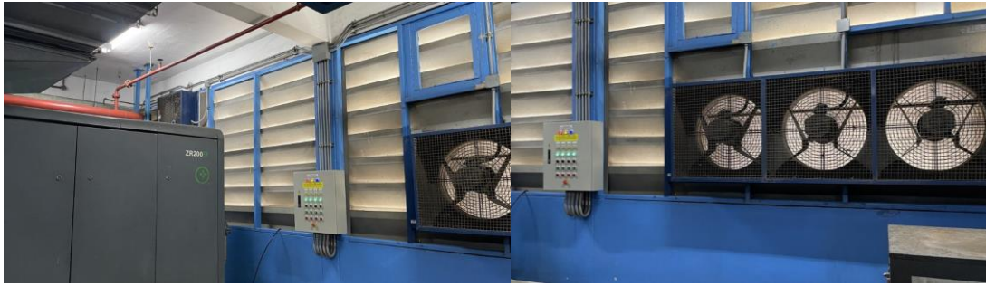
ภาพที่ 4.11 ปัญหาที่เกิดจากระบบระบายอากาศ (Ventilation and Exhaust)
