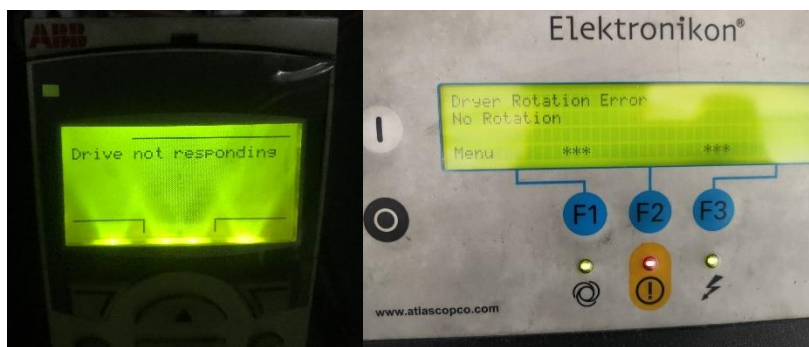
ภาพที่ 4.7 ปัญหาที่เกิดจาก VSD Drive not responding
