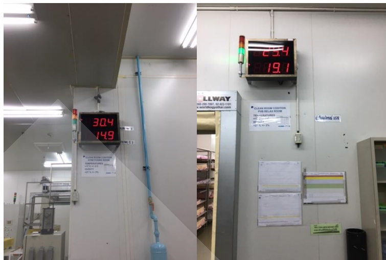
ภาพที่ 4.17 เครื่องควบคุมอุณหภูมิ และความชื้น
