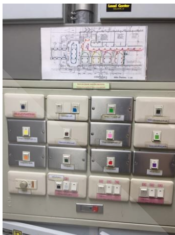
ภาพที่ 4.25 แผงวงจรระบบแสงสว่างภายในอาคาร
