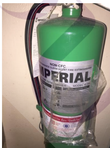
ภาพที่ 4.29 ภาพถังดับเพลิงภายในอาคาร
