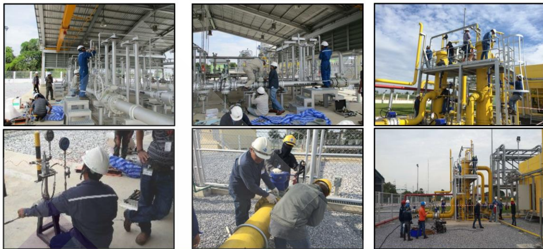
ภาพที่ 3.22 ภาพแสดงการตัดแยกระบบและปรับตั้งสปริงของชุดวาล์วควบคุมความดันก๊าซธรรมชาติ และ Pressure and Leak Testing with official test report with R-Stamp และ Re-Test and Certificate suction Piping N2 Flushing and Blanking of Gas Compressor Long Term Preservation.
