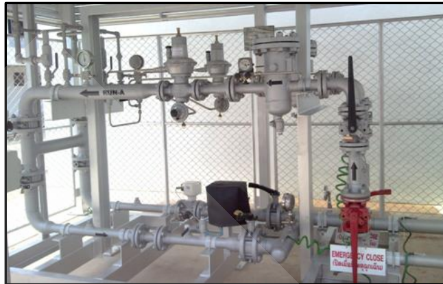
ภาพที่ 3.8 สถานีก๊าซฯ แบบ Skid Pack Type
