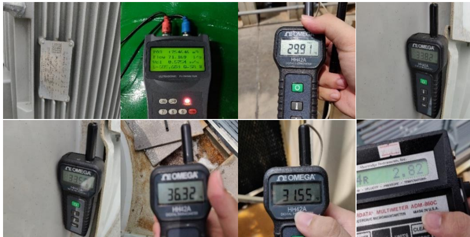
ภาพที่ 3.11 การวัดค่าพารามิเตอร์ต่าง ๆ เพื่อเทียบกับค่าดีไซน์ ของ(Cooling Tower)
