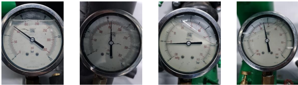
ภาพที่ 3.9 การวัดค่าความดันน้ำ(Pressure) ของเครื่องส่งน้ำเย็น(Chilled Water Pump)และเครื่องส่งน้ำหล่อเย็น (Condenser Water Pump)
