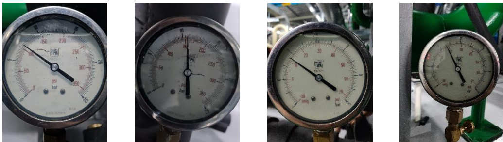
ภาพที่ 3.7 การใช้เครื่องมือวัดค่าความดันน้ำเย็นและน้ำหล่อเย็น เข้าออกจากเครื่องผลิตน้ำเย็น (Chiller) ด้วย Pressure Gauge
