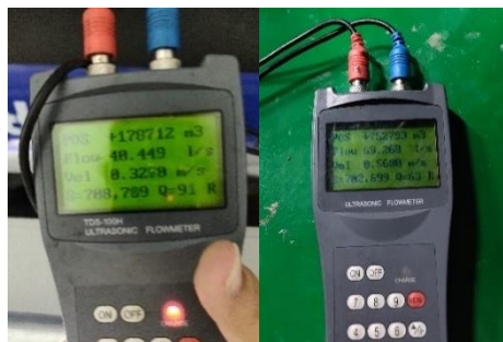
ภาพที่ 3.10 การวัดค่าอัตราการไหล(Flow) ของเครื่องส่งน้ำเย็น(Chilled Water Pump)และเครื่องส่งน้ำหล่อเย็น (Condenser Water Pump)
