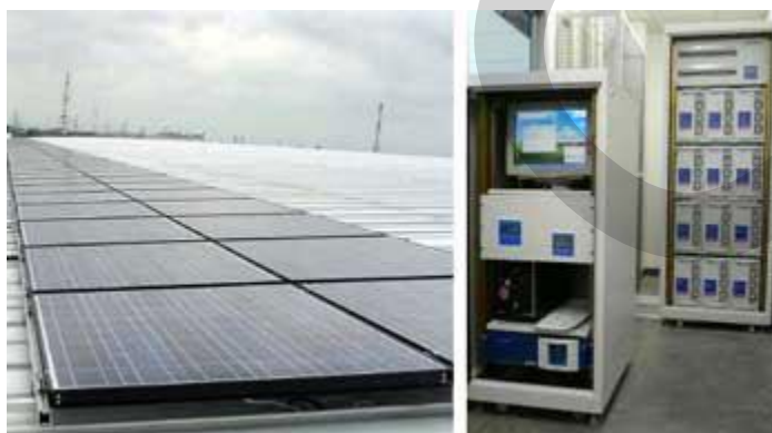
รูปที่ 2.6 ระบบเซลล์แสงอาทิตย์แบบเชื่อมต่อเข้าสายส่งที่ติดตั้งบนหลังคา
