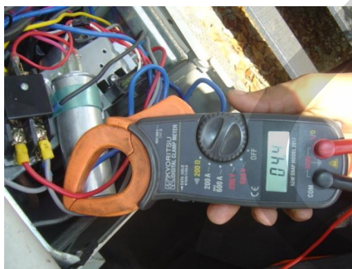
รูปที่ 3.7 คลิปแอมป์ในการทำการตรวจวัดกระแส
