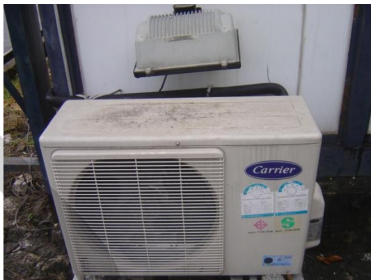
รูปที่ 3.2 การติดตั้งคอนเดนซิ่งยูนิต (CDU) ของเครื่องปรับอากาศแบบแยกส่วน
