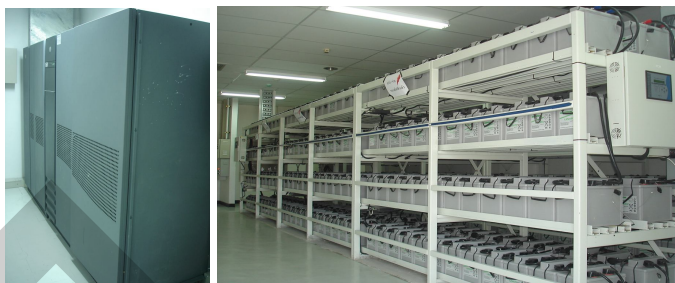
รูปที่ 2.16 Static UPS และแบตเตอรี่
