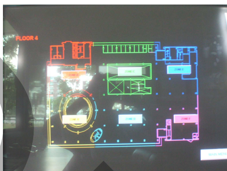
รูปที่ 3.34 ระบบควบคุมการเปิด - ปิดไฟฟ้าแสงสว่างในอาคาร
