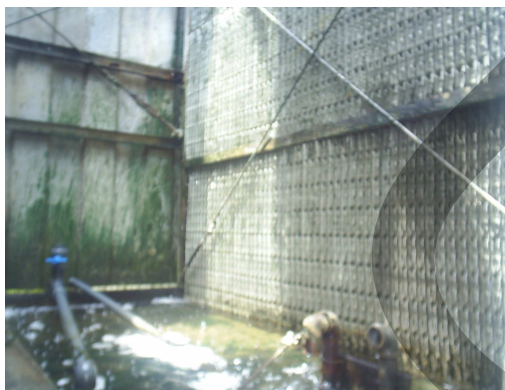
รูปที่ 4.13 การบำรุงรักษาหอผึ่งเย็น (Cooling Tower)
